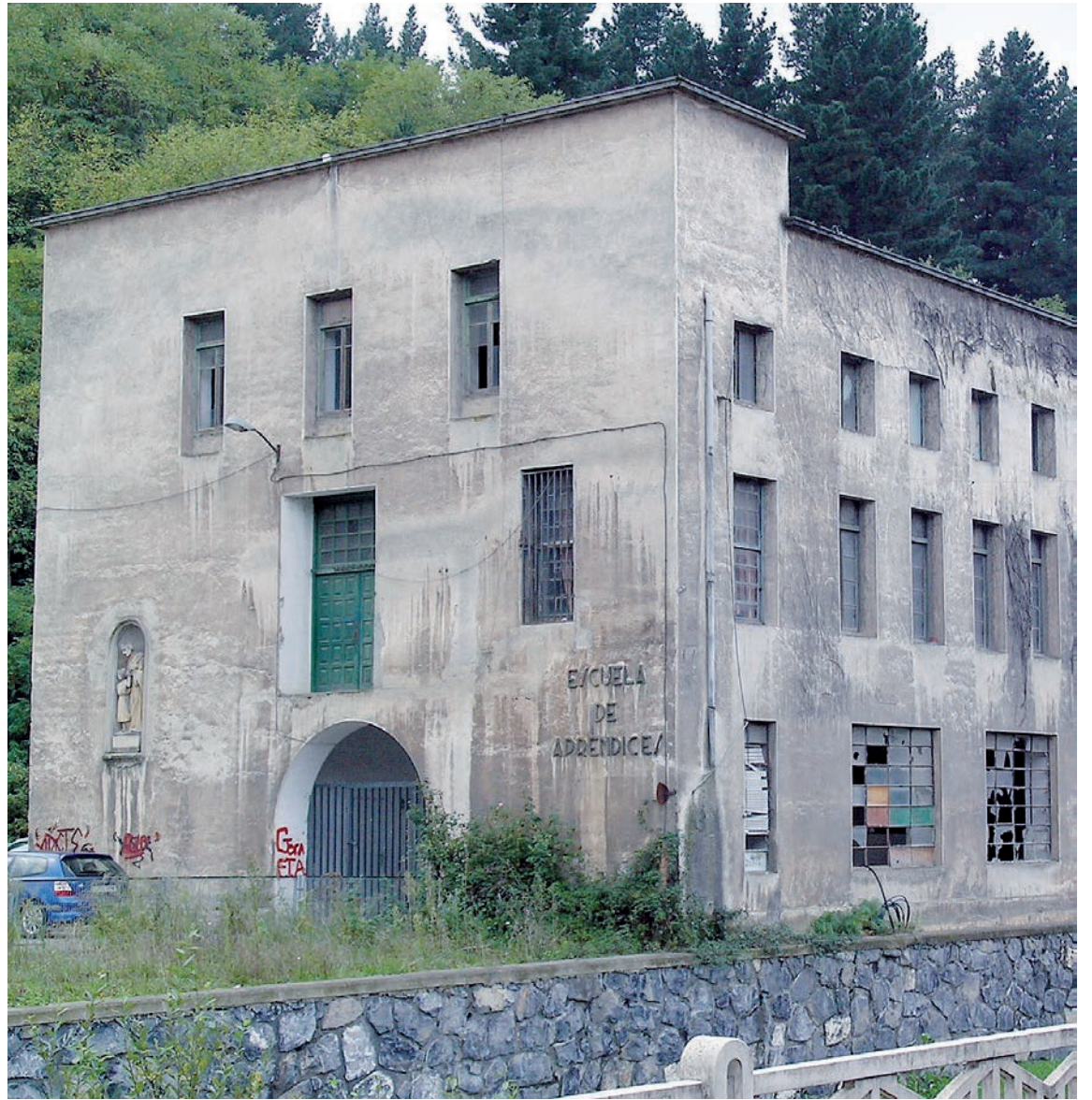
APRENDIZEN ESKOLA Saiolan eraikinaren ondoan dagoen Aprendizen Eskola txarto dago; arrakalak ditu.
