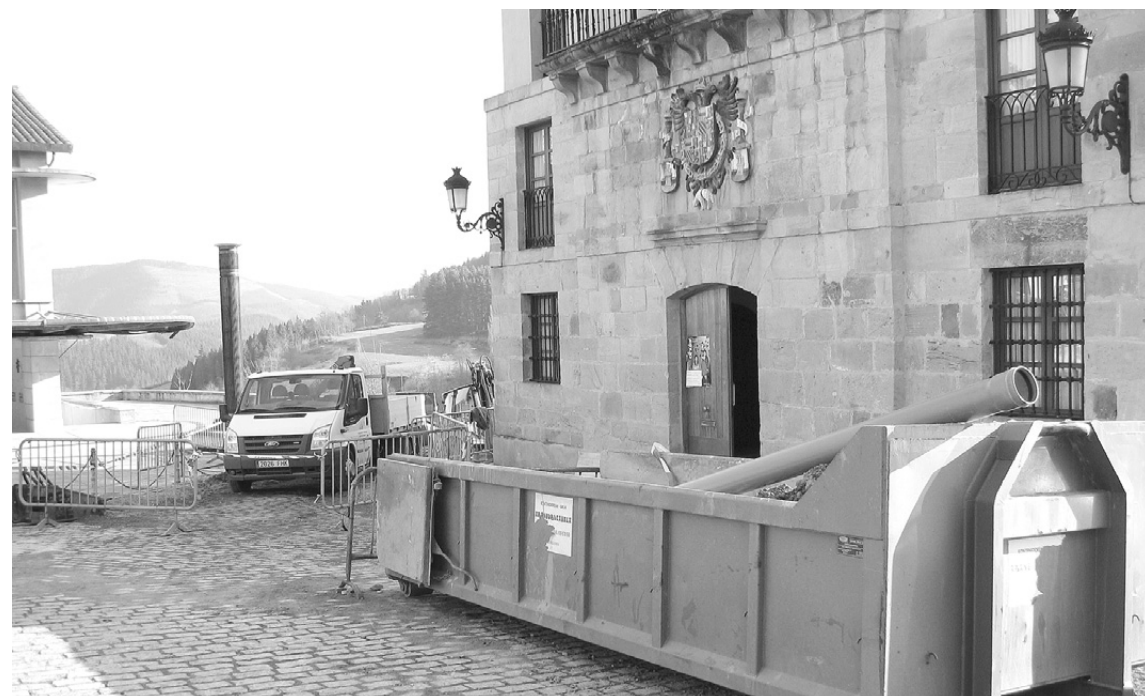
LANAK San Migel plazan, udaletxe aurrean, zulatu dute kalea azpiegitura lanak egiteko.
