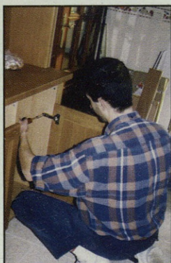
Muntaiaren akabera ezinhobea.
