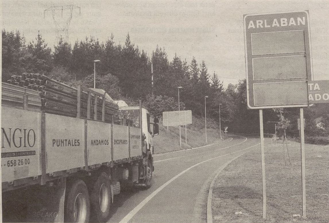
Garraio astuneko ibilgailuek erabiltzen dute errepide hori gehien, eta horrek erraztu egiten du asfaltoan maldak sortzea.
