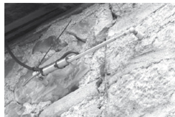
Fisuometroa, pitzaduran. | U.M.
