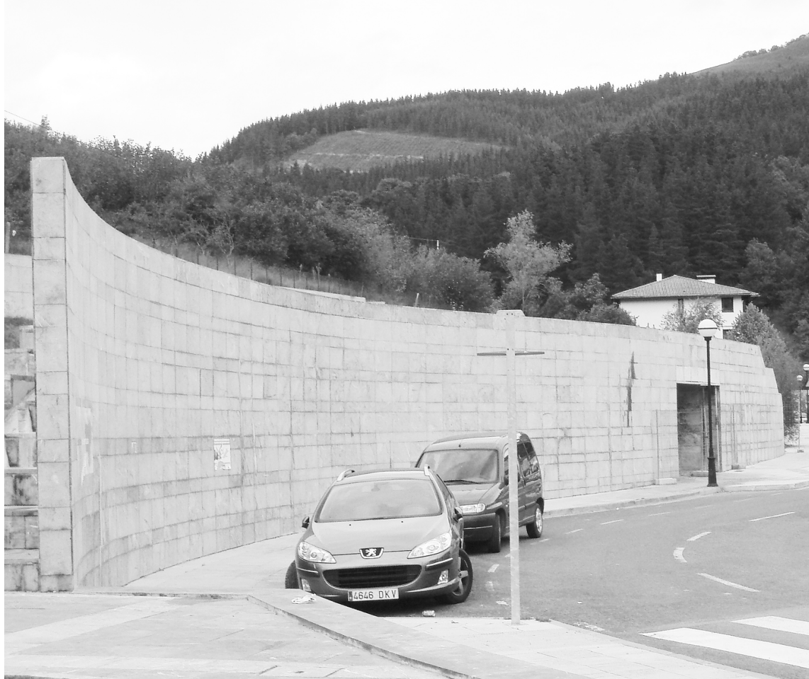
PARETA Enpresa eraikitzaileak uste du Pedro Inazio Barrutia kalean eraikitako paretak jausi egin daitezkeela obrak hasiz gero. U.M.
