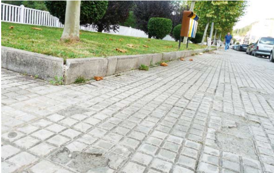
Belorrietako espaloiek zulo ugari dituzte eta azaroan konpoduko dituzte. | Z.V.D.M.
