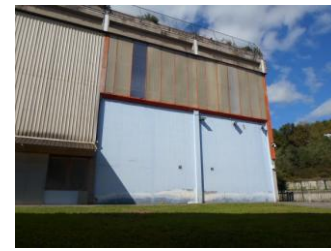
Antoñako aurreko estalki hau hormigoiez estaltzen da. Bertan kanpoko rokodromoa eraikitzen da.
